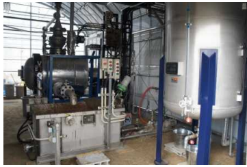
水熱処理装置による下水汚泥 や生ごみの可溶化
