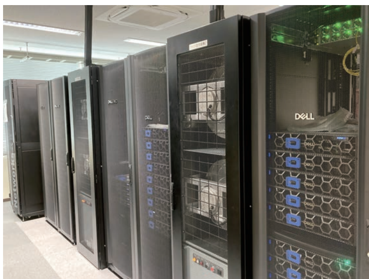
サーバラック（情報メディア基盤センター 通信システム室）
